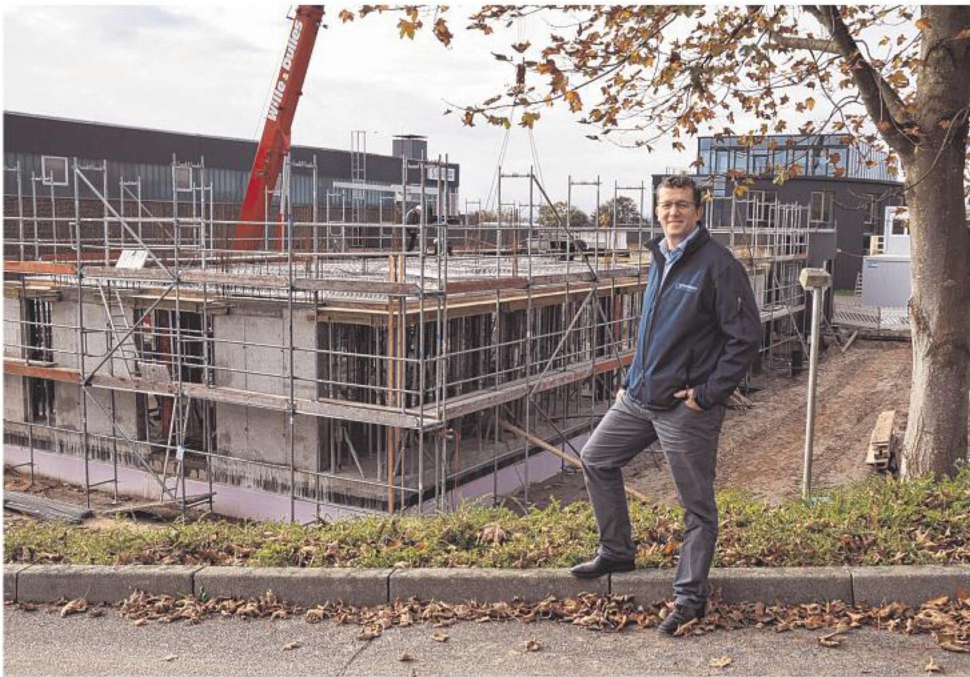
Der Anbau nimmt Formen an: Projektleiter Bernd Börensen ist zufrieden mit dem Fortschritt der Bauarbeiten.
